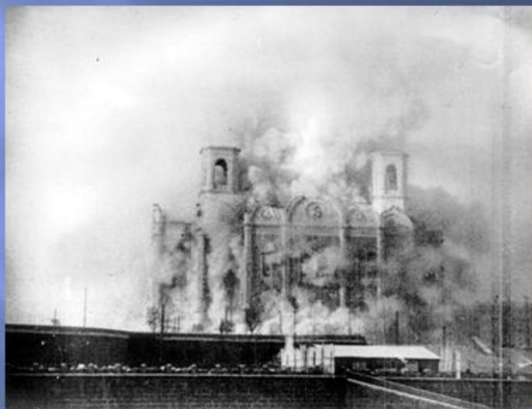
В 1931 году на заседании ВЦИК было принято решение о сносе храма. В 1960 году на месте собора появился открытый плавательный бассейн «Москва», просуществовавший до 1994 года.
